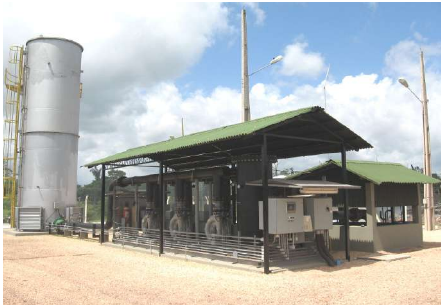
Figura 19 - Estação de Queima de Biogás no Aterro do Aurá. Fonte: Arquivo CRA. 2010
